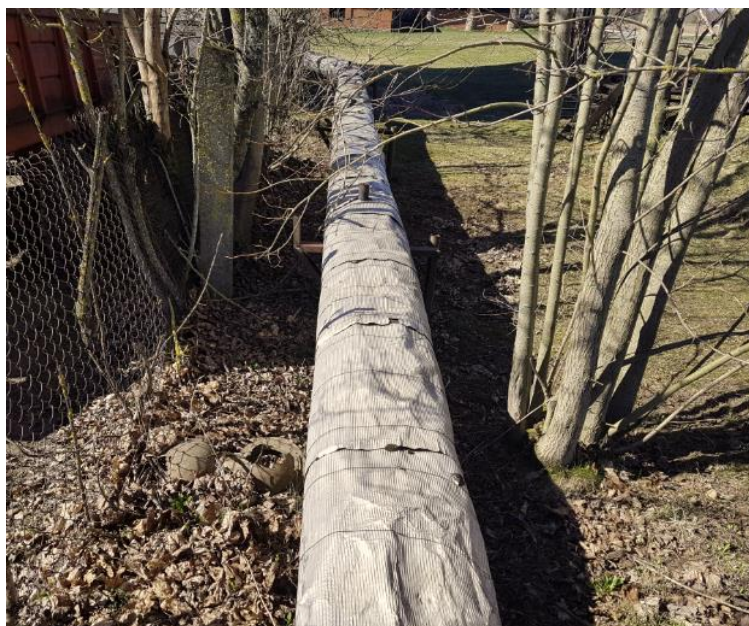
Joonis 4. Katlamajast väljuv maapealne torustik
